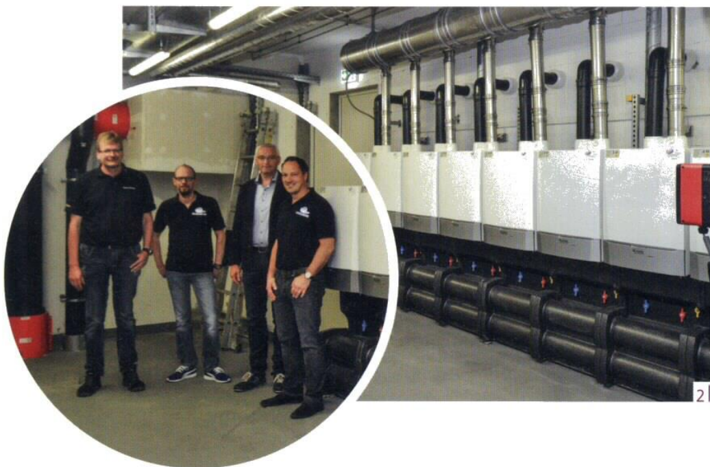
2 | Der Arbeitsbereich der in Kaskade geschalteten acht „Quinta Pro“-Gas-Brennwertgeräte ist enorm: Im Bereich von 20,5 bis 920 kW effektiver Heizleistung lässt sich die Anlage modulieren. Im Bild (v.l.n.r.): Guido Lambers, Abteilungsleiter Energieerzeugung und Contractinganlagen der nvb, Matthias Kreuz, Geschäftsführer Activa Haustechnik, Frank Draber, Vertriebsingenieur Remeha, Mario Matos da Silva, Geschäftsführer Activa Haustechnik. (Foto: Remeha)
